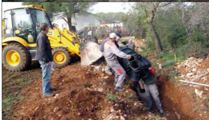
Fekalna kanalizacija u Šuridi
