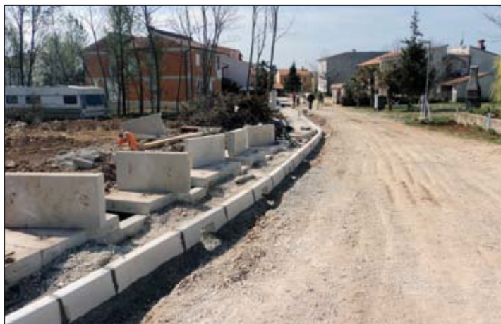
Odvodni kanali u Valbandonu - Ulika i...
